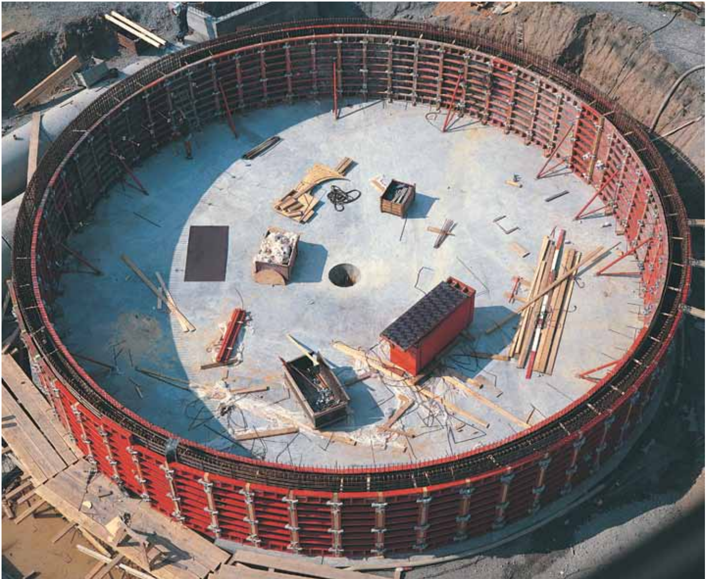
Tanque de contención de agua pluvial, diámetro aprox. 18 m, encofrado con paneles TRIO TR 270 x 90.
