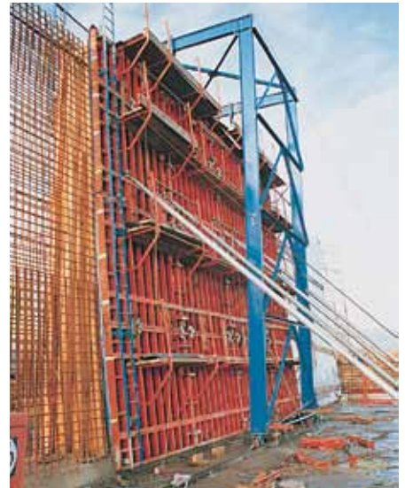
Unidad completa de TRIO de 8,40 m de altura (encofrado interior y exterior col- gado de un pórtico móvil).
