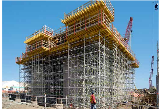
Con PERI UP Rosett y MULTIFLEX se descargaban con toda seguridad los esfuerzos de partes macizas a una altura de entre 10 y 12 metros al suelo.
