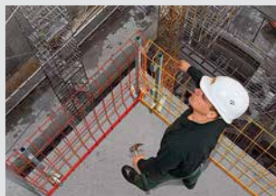
Sistemas de Seguridad
